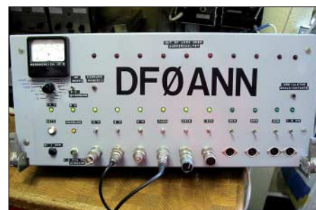
Basisstation der Bake, die Koaxialkabel ab 9 cm sind im Dachboden des Turmes nahe am Antennenfuß untergebracht, um die Leitungsdämpfung zu minimieren. Alle Frequenzen sind an einen Quarzthermostaten mit sehr hoher Genauigkeit über eine PLL angebunden. Fotos: DL8ZX
